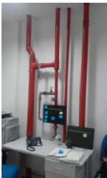
Figura 5 – Uso inadequado de local destinado a equipamentos de segurança.
