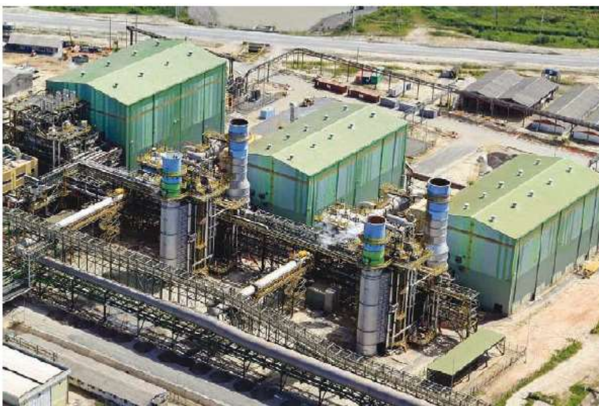
FIGURA 2. Foto das caldeiras de recuperação da Usina Siderúrgica do Atlântico. Fonte: Vieira (2015)
