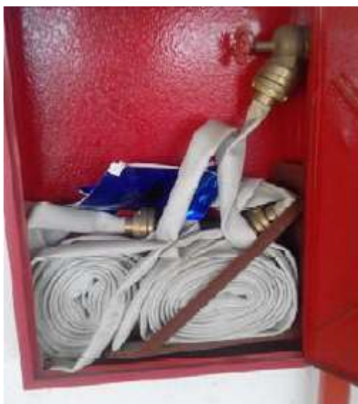
Figura 4 – Hidrante com corpo estranho no interior do abrigo.
