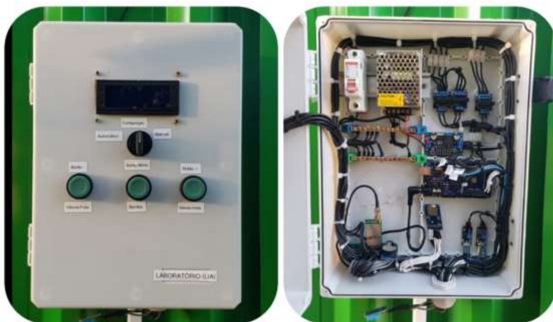
Figura 3 – Quadro de comando principal do sistema de irrigação.
