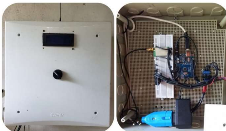
Figura 10 – Quadro localizado no poço artesiano.
