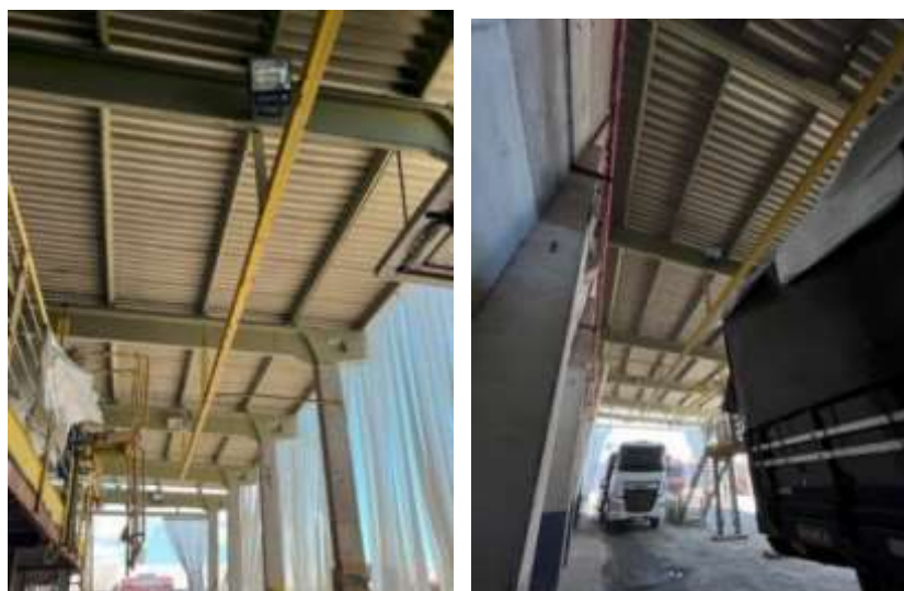
Figura 4. Lâmpadas da linha de carregamento.
