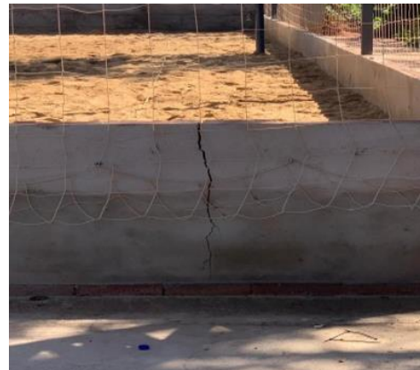
Figura 5-Trinca na alvenaria não estrutural
