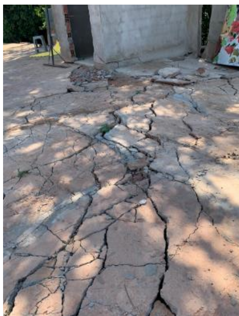
Figura 9- Rompimento do piso de concreto
