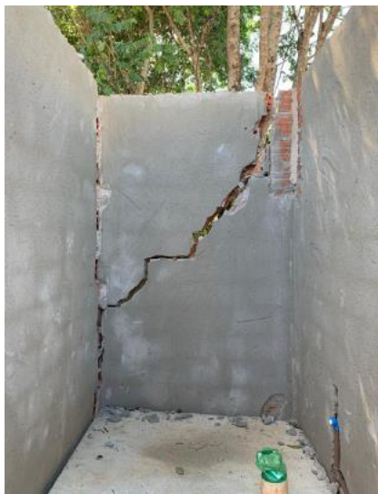
Figura 6- Fendas instaladas no banheiro
