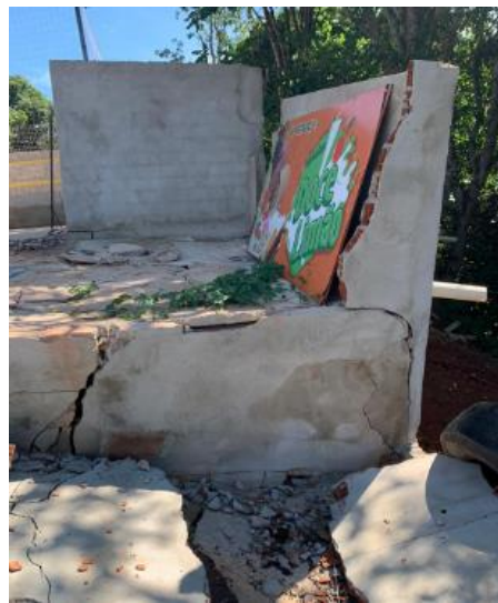
Figura 7- Fendas na base da quadra
