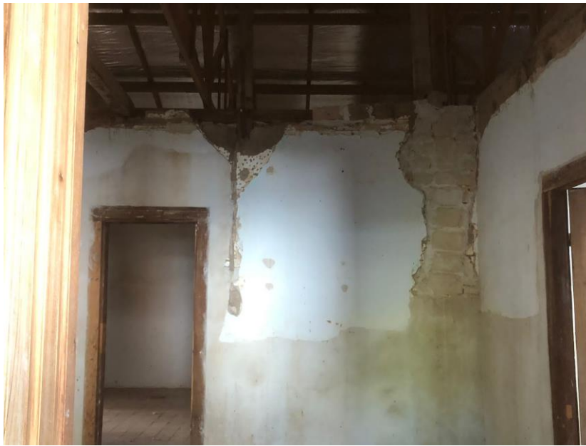
Figura 3 – Rachaduras das paredes
