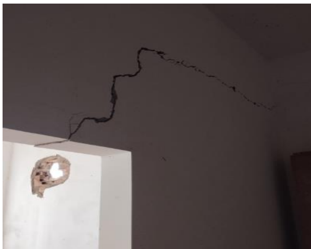
Figura 11 - Rachaduras em aberturas. Localizada na (Despensa). Reforço: Bloco 6, estacas 11 e 12, conforme a figura 13.
