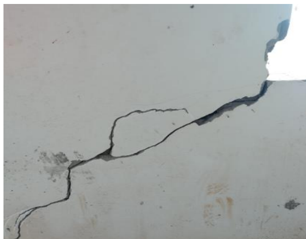
Figura 10- Rachaduras de canto de parede Localizada no (Refeitório). Reforço: Bloco 1, estacas 1 e 2, conforme a figura 13.
