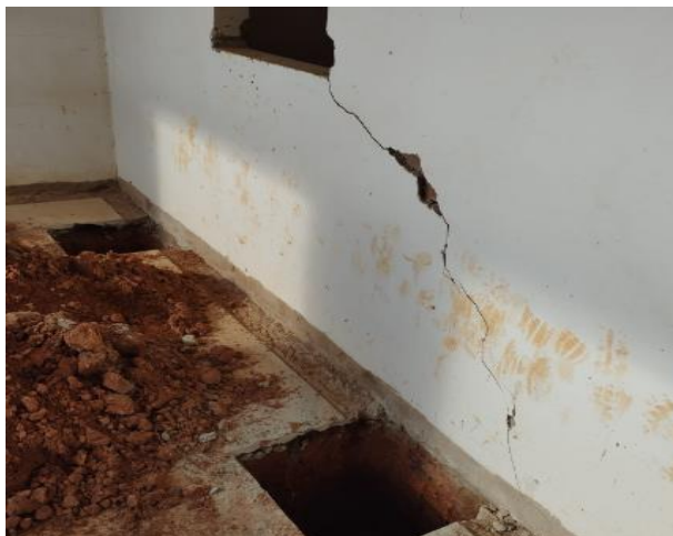
Figura 9 - Trincas a 45°, em fase de evolução – Localizada no (Refeitório). Reforço: Bloco 4, estacas 7 e 8, conforme a figura 13.
