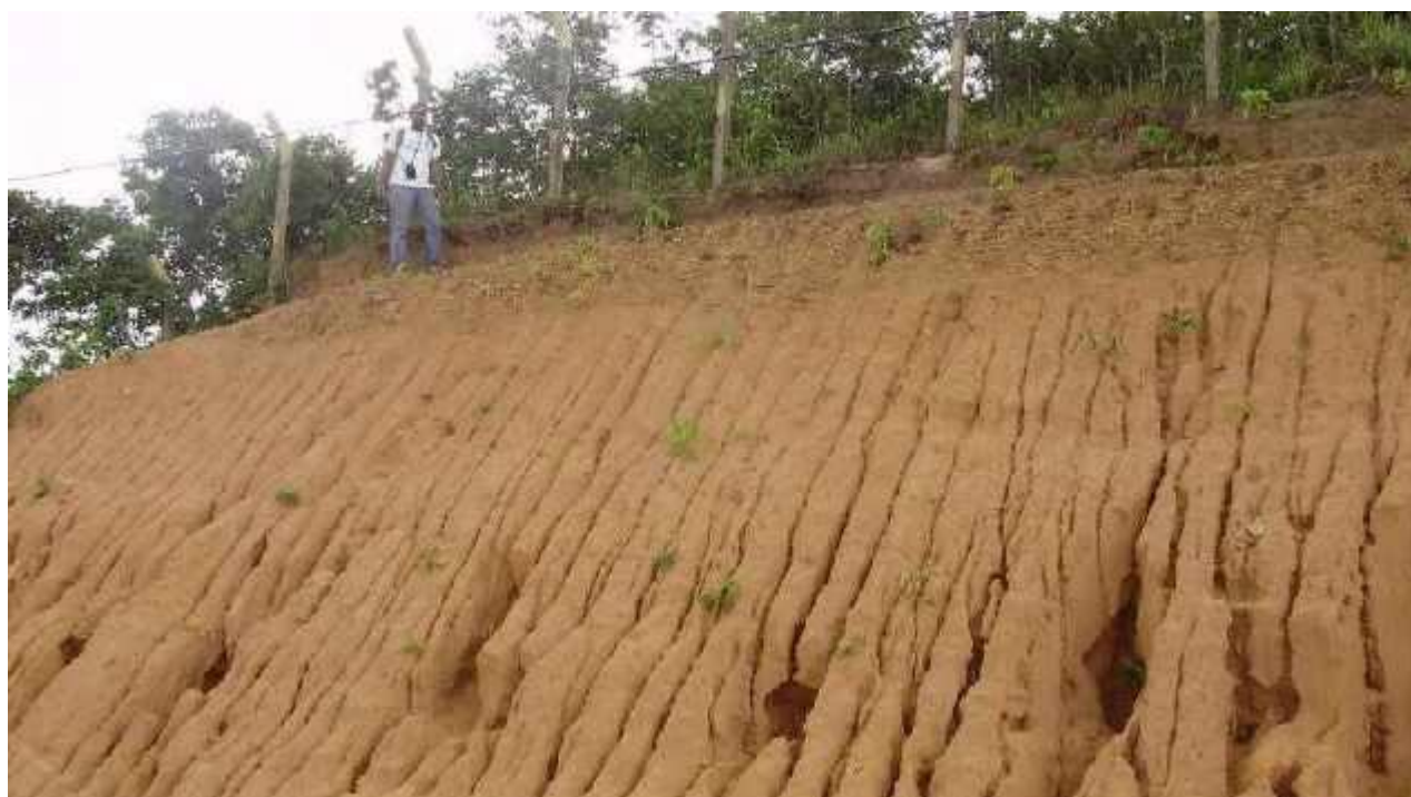
Figura A1.66 - Stone line acima do talude escavado na BR 135.
