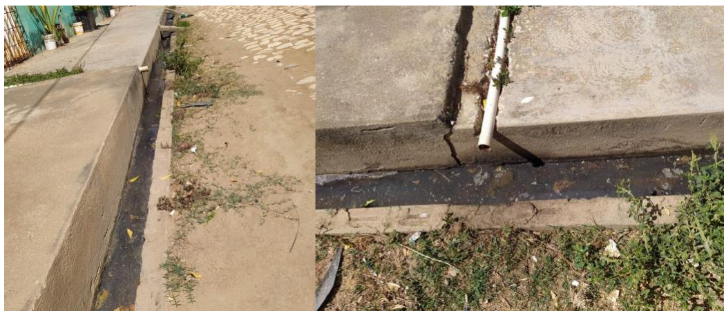
Figura 13. Esgoto a céu aberto no bairro Santa Helena, Mossoró/RN.
