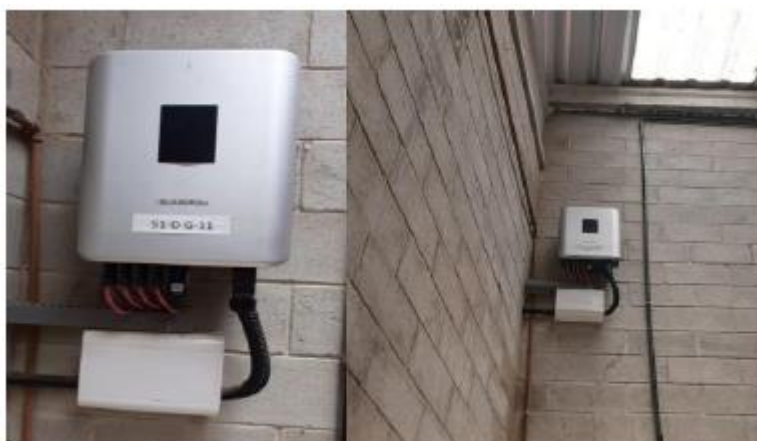
Figura 20 - Foto do inversor instalado
