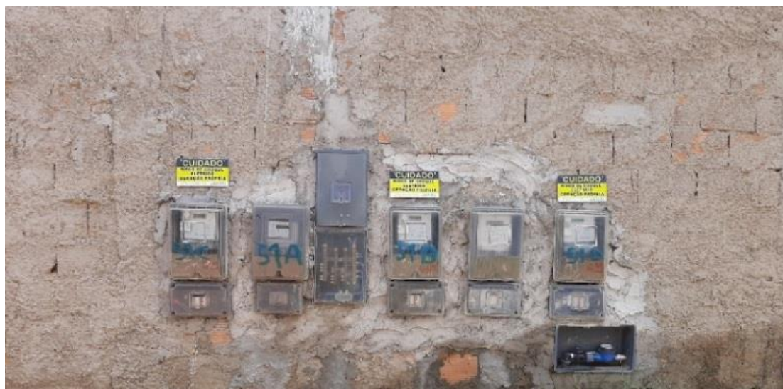
Figura 19 - Quadro de medição coletivo com 5 medições
