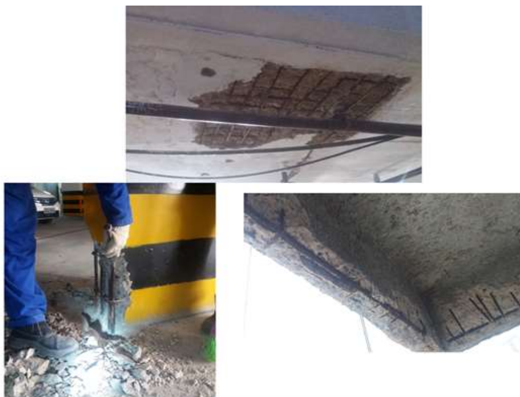
Figura 3 – Corrosão da armadura em lajes, pilares e vigas
