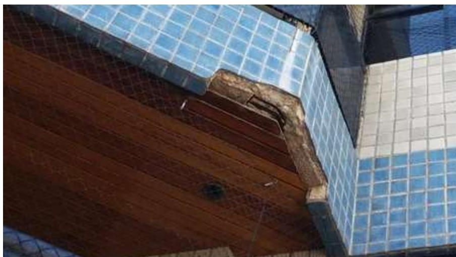
Figura 5 – Corrosão da armadura na viga de bordo da fachada
