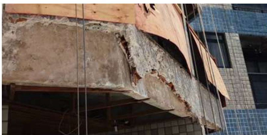
Figura 4 – Deslocamento do emboço da viga da fachada
