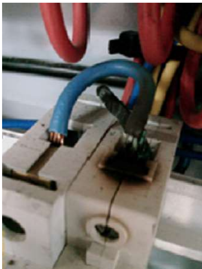
Figura 2: Identificação da falha.
