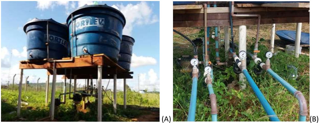
Figura 5. Conjunto de caixas de polietileno (A) e conjunto de bombas (B).
