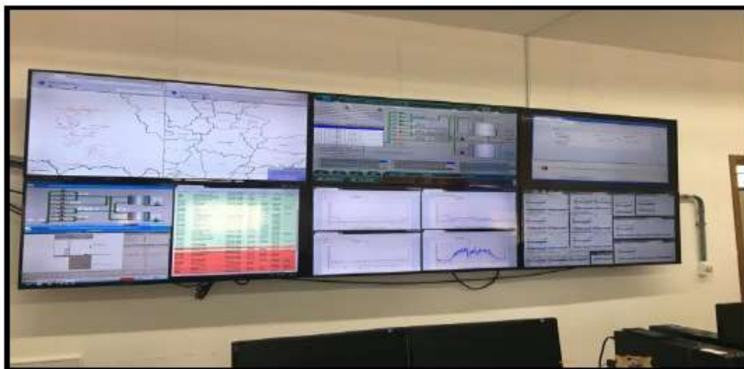
Fig. 7 CCO Centro Controle Operacional – Bragança Paulista
