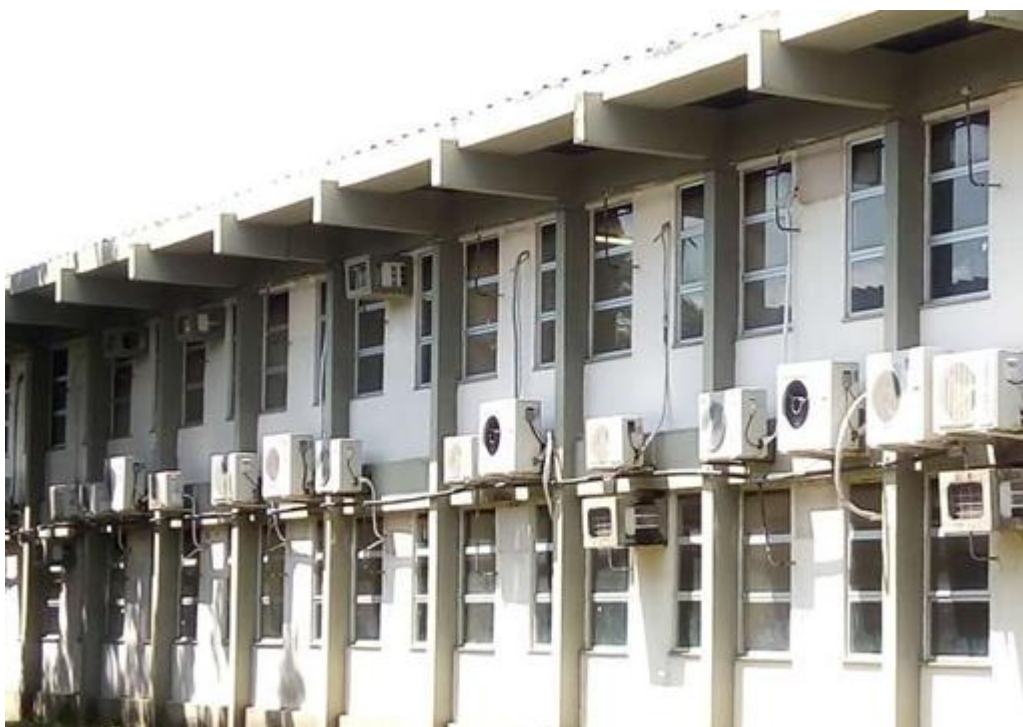
Figura 4.1 - Diferentes equipamentos de refrigeração
