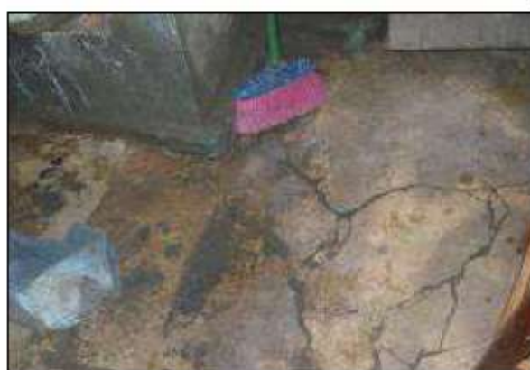
Figura 10 - Descolamento no piso
