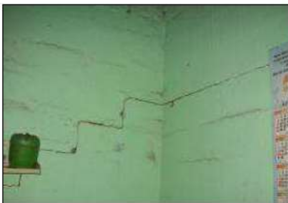
Figura 5 – Rachaduras na argamassa de assentamento
