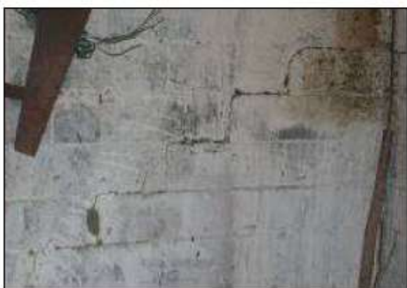
Figura 9 – Bolor e Manchas de Infiltração
