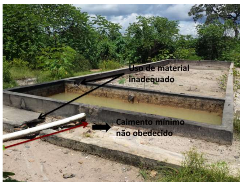
Figura 7: Tanque de zona de raízes com detalhamento de erros construtivos identificados.
