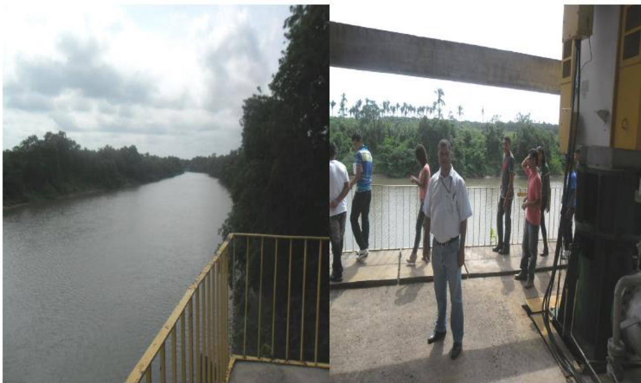
Figura 23 – Imagem do rio Itapecuru, fonte captora de água para a ETA, e da plataforma de elevação com uma de suas 06 (seis) bombas sucçoras utilizadas nas operações de elevação e de captação de água para alimentação do sistema de tratamento convencional de água, Italuis, localizado em São Luís, Maranhão, Brasil.
