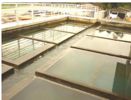
Figura 5. Tanque de decantação.
