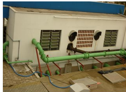
Figura 8. Casa das bombas.
