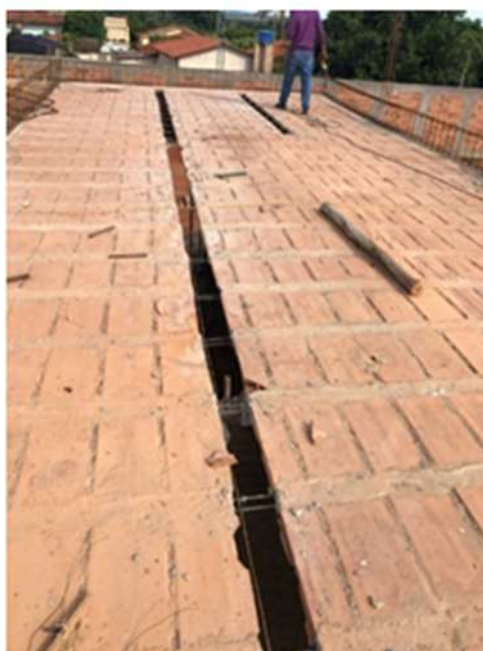
Figura 5- Ausência da capa de concreto
