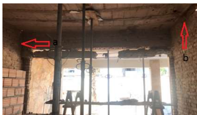
Figura 7- Pontos sem Pilar e sem viga de Cobertura
