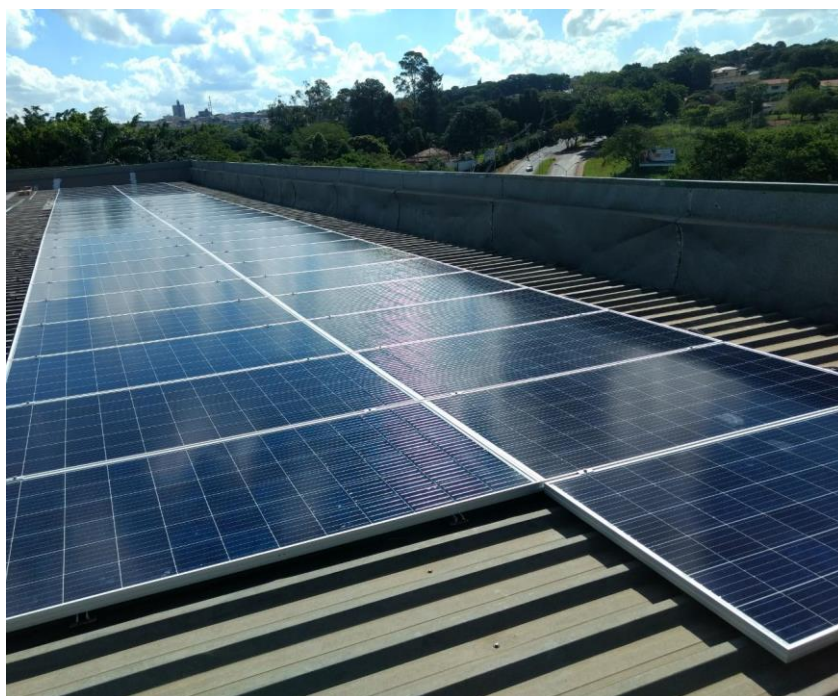
Figura 2 – Usina fotovoltaica do Campus
