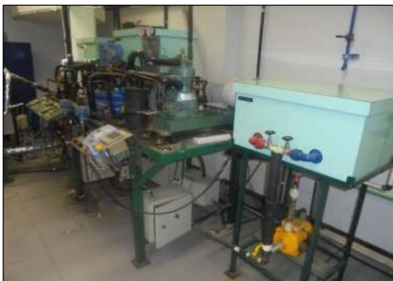
Figura 4.2 - Máquina frigorífica da qual virá a água gelada para o condensador
