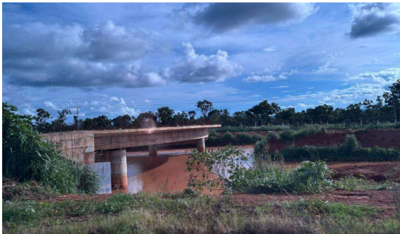
Figura 29 - Obra de viaduto abandonado desde 2020
