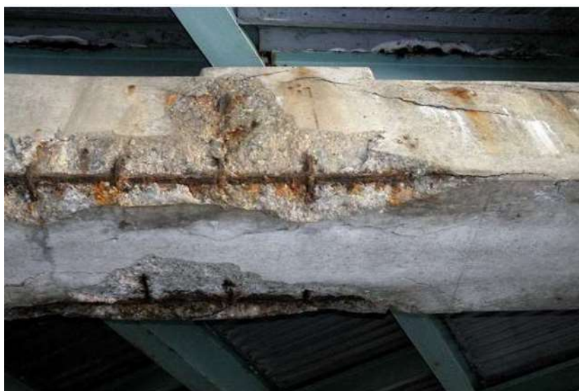
Figura 5: Corrosão de armadura por decorrência da carbonatação
