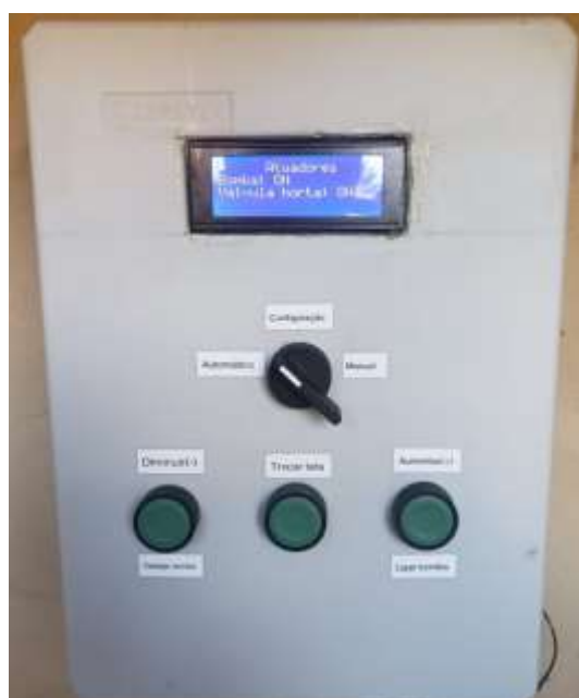
Figura 2. Quadro de comando.
